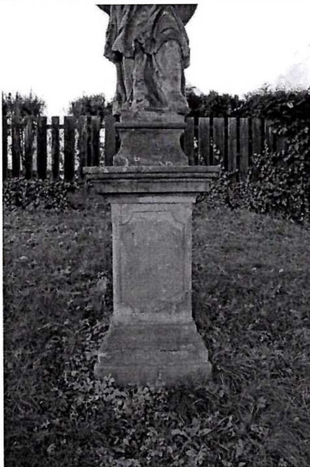
Pohled na problematické spodní partie profilovaného podstavce a nevhodně navýšený terén.
